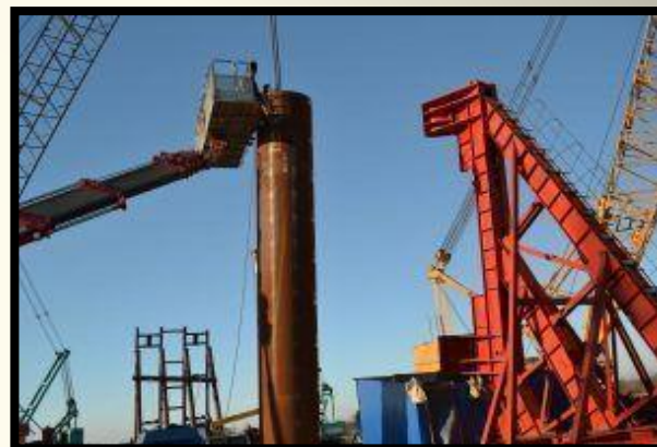
Буронабивные сваи изготовлены на месте – установлена арматура в скважину и залита полость бетоном
